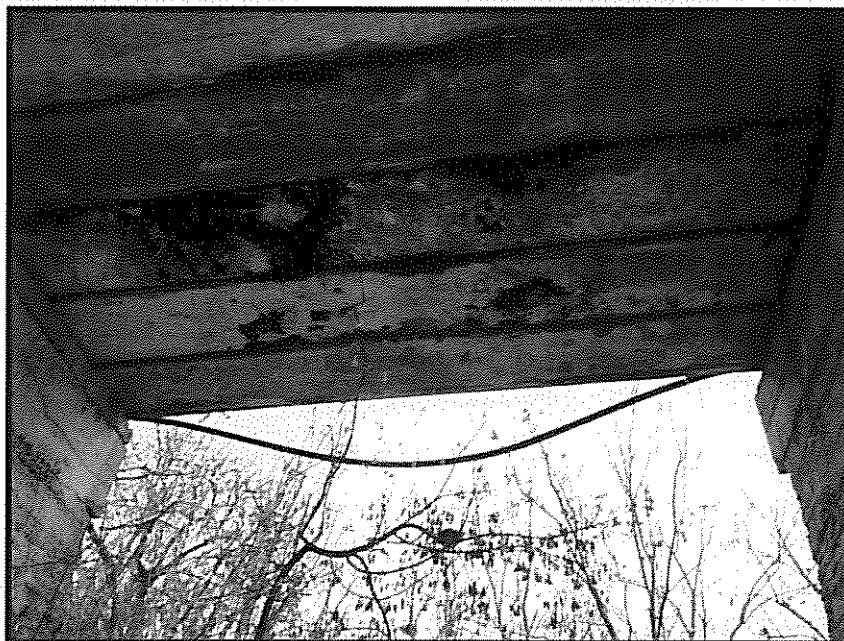
Foto nr. 1 - Coroziunea armăturii, pete de rugină la nivelul tălpii inferioare a fâșiilor cu goluri prefabricate
